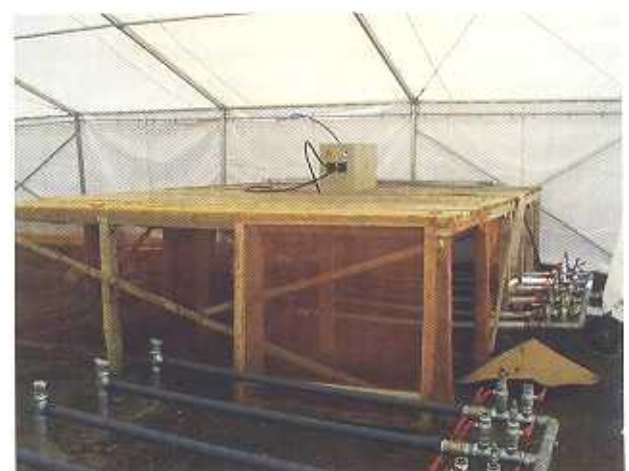
Versuchsanlage zur Radiofrequenz-Boden Erwärmung. Quelle: Helmholtz-Zentrum für Umweltforschung GmbH – UFZ
